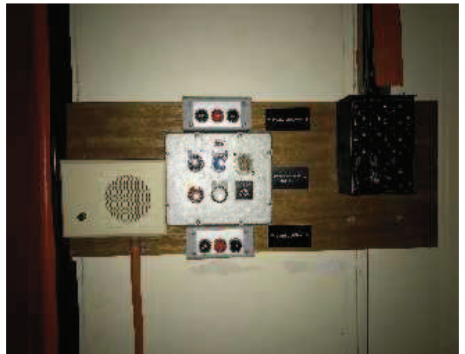
AUDITORIUM – AV CONTROLS
